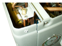
Odvzdušňovací ventil na primárním okruhu
