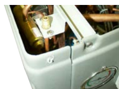
Odvzdušňovací ventil na primárním okruhu
